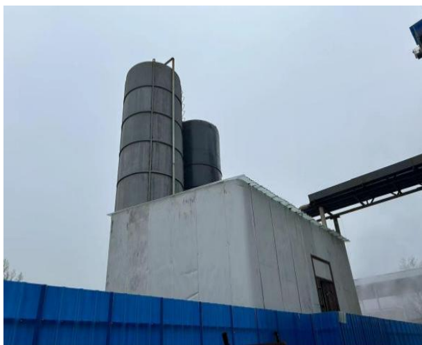
石灰石储存罐
