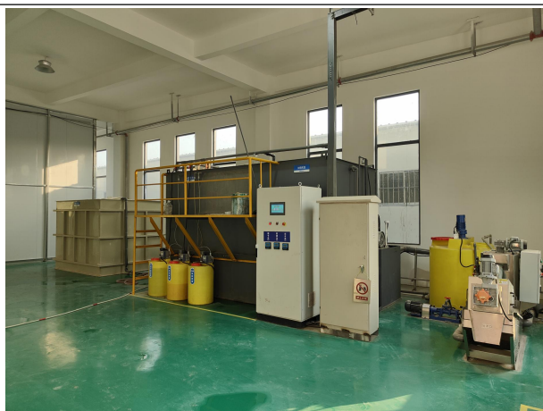
厂区污水处理站
