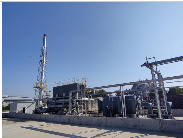
厂区沉积、包覆尾气处理系统
