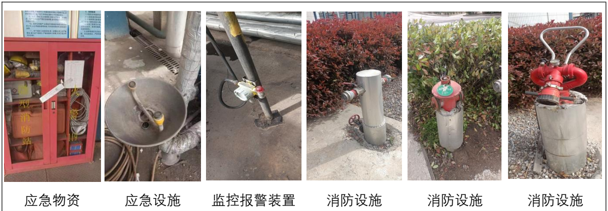
图 6.8-4 河南首成科技新材料有限公司部分应急救援装备
