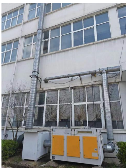
现有工程有机废气处理设施
