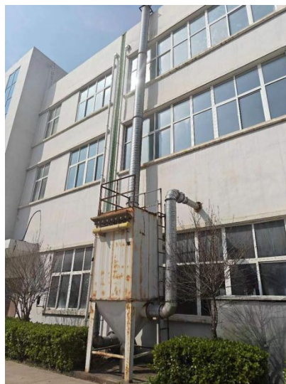
现有工程袋式除尘器
