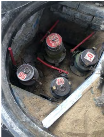
一次油气回收装置
