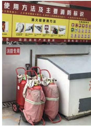
厂区内消防设施
