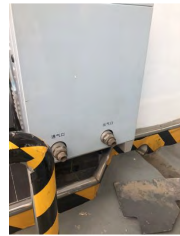
三次油气回收装置预留口
