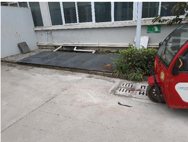
现有混凝沉淀池
