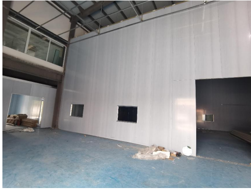
生产车间内部
