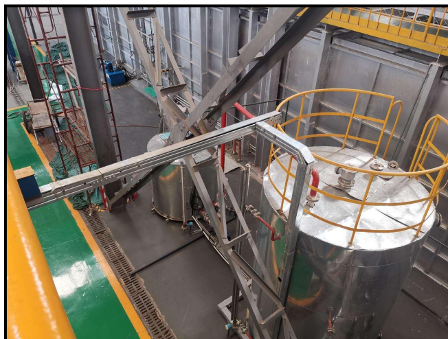
二烧车间 SCR 设施尿素系统
